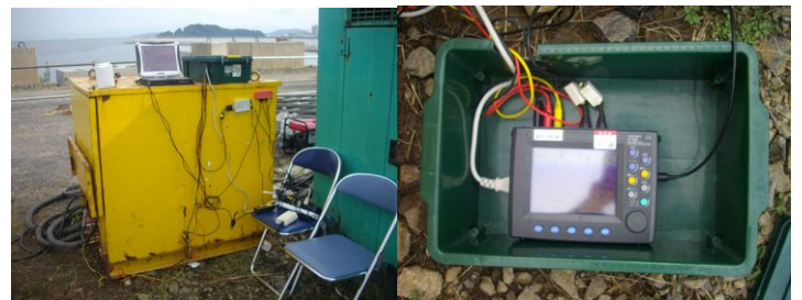
電動式バイブロハンマの場合：発電機と電力センサ
