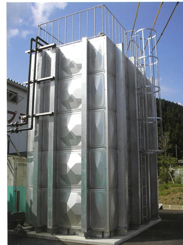
■外部補強タンク(保温付)
