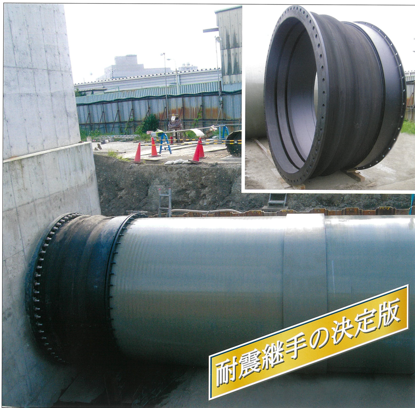
構造物とFRPM管との取合部に設置されたスーパージョイント口径3000mm
