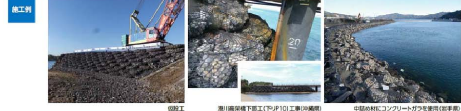
仮設工 瀬川高架橋下部工(下りP10)工事(沖縄県) 中詰め材にコンクリートガラを使用(岩手県)
