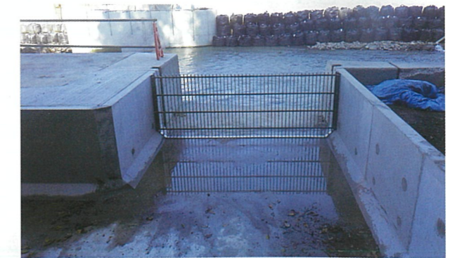
九州地方整備局筑後川河川事務所 花月川城内頭首工改築工事 3000×1100
