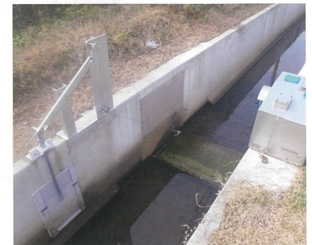
倒伏後全閉状態
