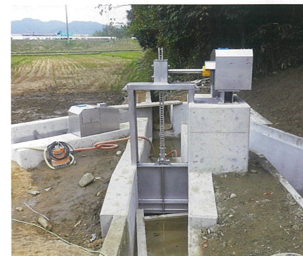
山口市役所下水道課 門田雨水貯留施設設置工事 自動降下式 600×680
