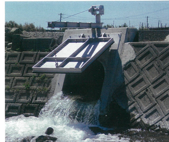
八代地域振興局/平和地区経営体育成基盤整備事業台号工事 920×1100
