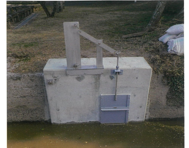
倒伏連動部 / 取水設備
