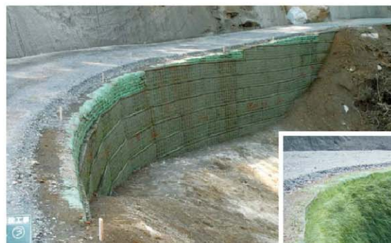
鳥取県 林道新設工事 ・壁面の高さ(m):5 ・壁面の勾配:1:0.2 ・縦断壁面積(m 2 ):87
